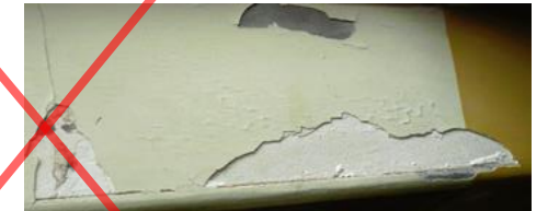
Plâtre contenant peinture au plomb
